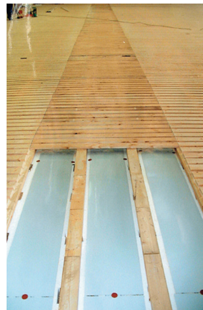
Mit Blechtafeln abgedeckte Sportbodenheizung
