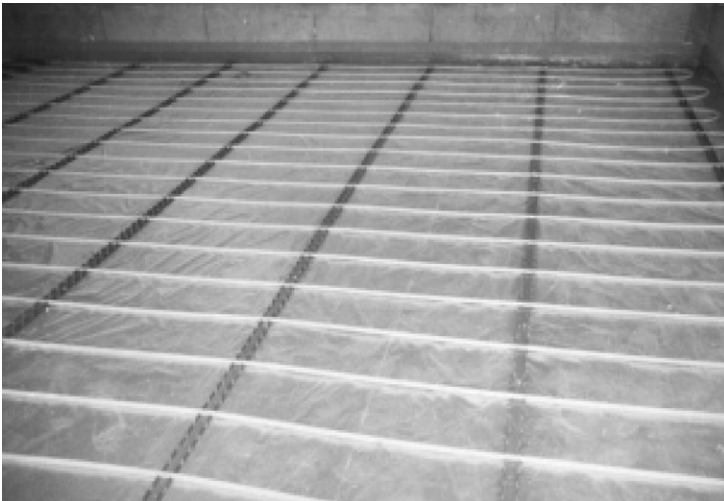
Bild 3: Betonkonstruktion ohne Mattenbewehrung
